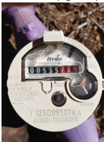
Figura 35. Contador volumétrico Itrón LNE 1797.6 (Fuente: fotografía propia).
