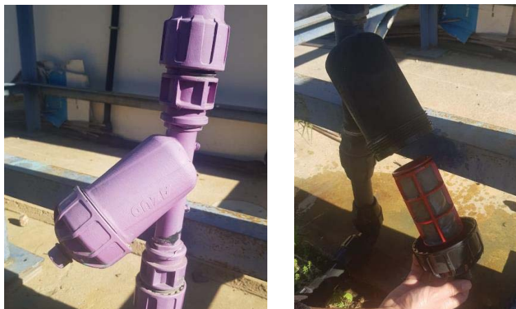
Figura 34. Filtros de malla AZUD Modular 100 (Fuente: fotografías propias).
