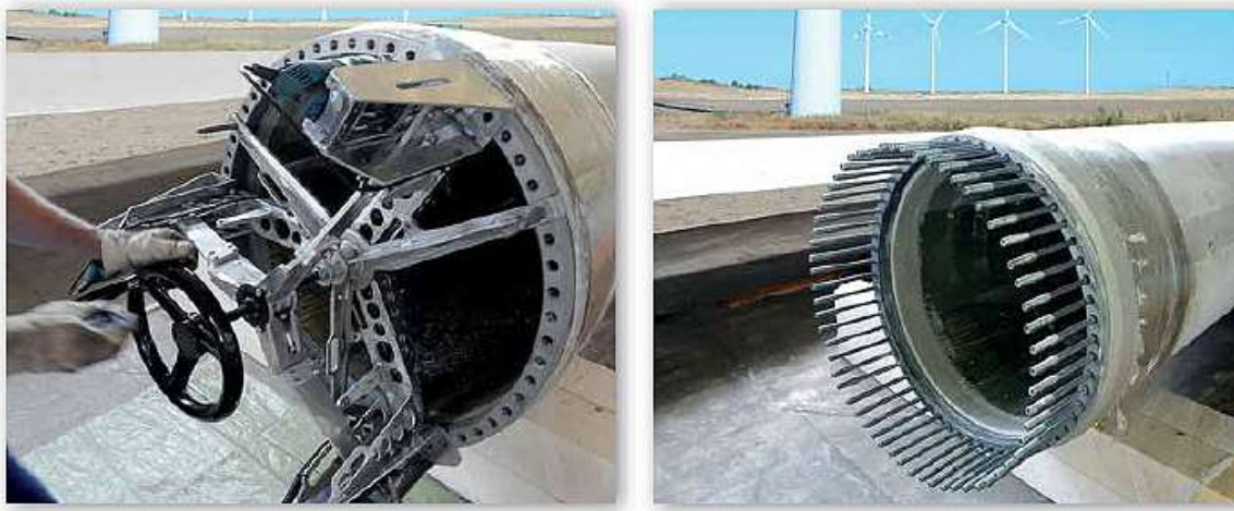
Figura 60. Pernos colocados en la base de la pala.
