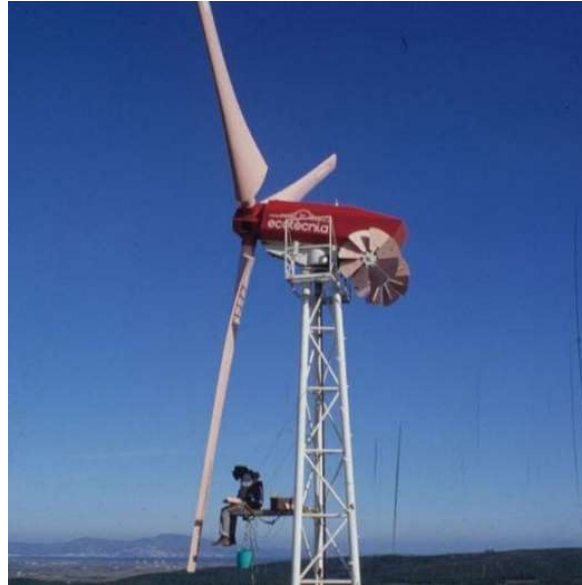
Figura 5. Aerogenerador Ecotècnia 12/15 instalado en Vilopriu.
