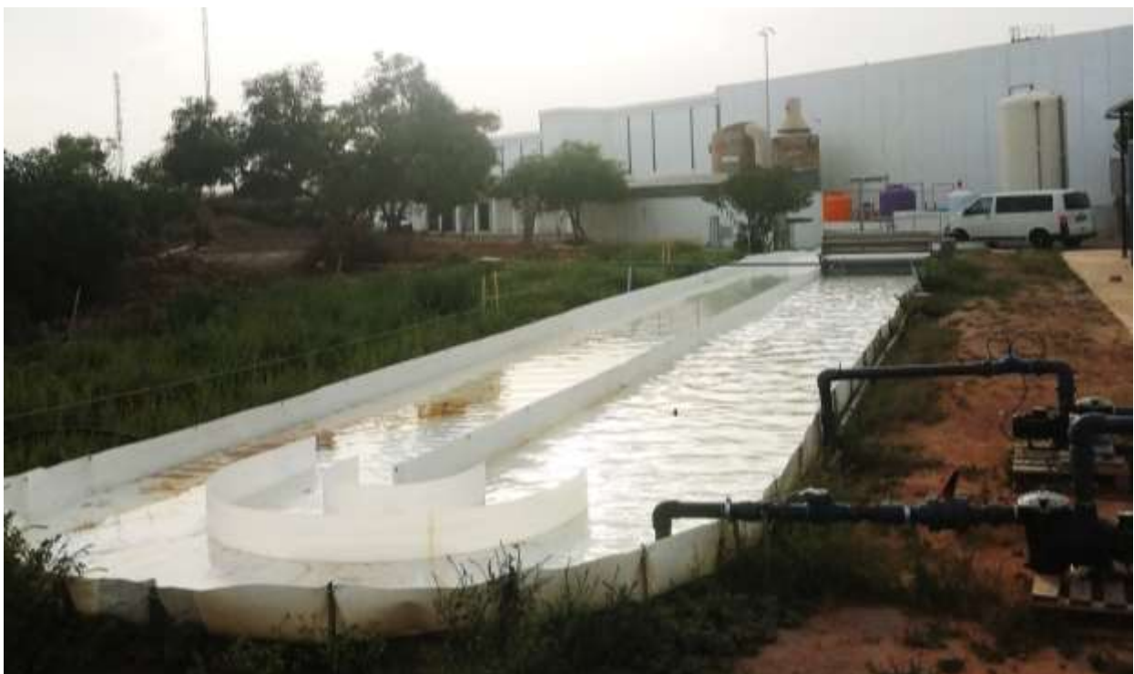
Figura 37. Reactor Raceway de la Planta de regeneración de aguas foto Fenton del proyecto ULISES
