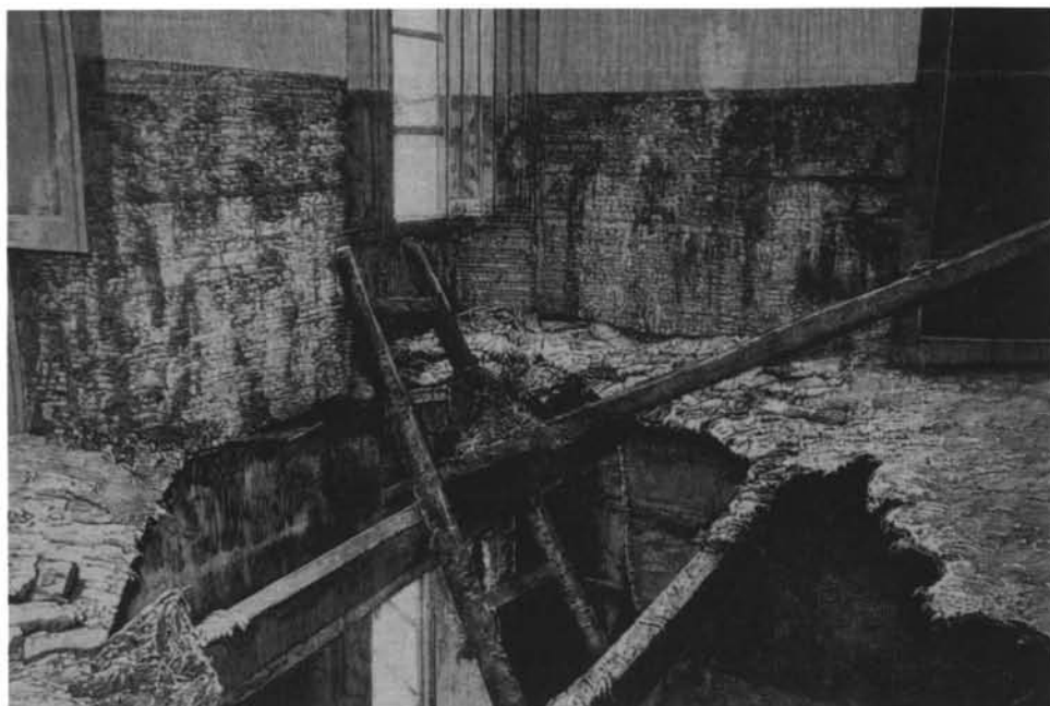
Foto 12 Pavimento del piso principal del colegio de la Compañía de María destruido por el empuje de las aguas (“La Ilustración Española y Americana”. 1891. Hemeroteca Municipal de Madrid)
