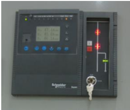
Figura 7. Detalle del relé de protección Sepam de la marca Schneider Electric ®.
