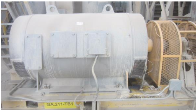
Figura 8. Motor de rotor bobinado que mueve la trituradora de martillos de la caliza. Características: Siemens 710 kW, 1475 rpm, 6kV, 84 A. Arranque mediante reóstato líquido.
