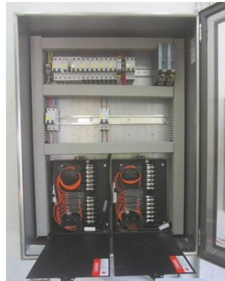
Figura 26. Detalle de una caja de campo para el fusionado de las fibras ópticas y la conversión a cableado eléctrico.
