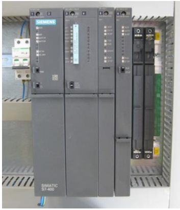
Figura 29. Detalle del PLC utilizado para el control de la instalación de la gama Simatic S7 400. Módulos instalados: Fuente de alimentación PS 407 10A, CPU 416-3 PN/DP, Tarjeta de comunicaciones Ethernet CP 443-1 y tarjeta de comunicaciones Profibus CP 443-5 EXT.
