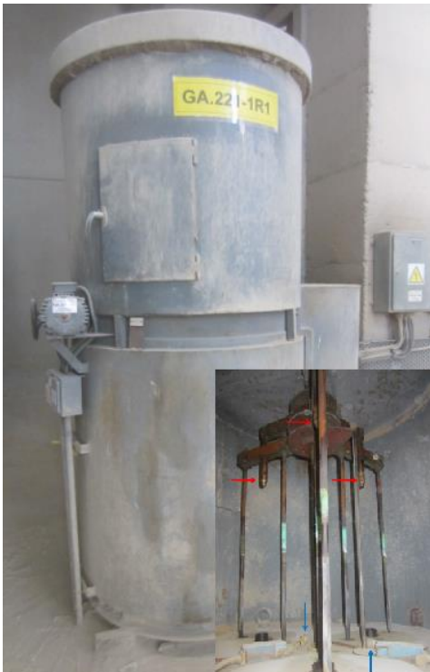
Figura 10. Reóstato líquido utilizado para el arranque de la trituradora de marga.
