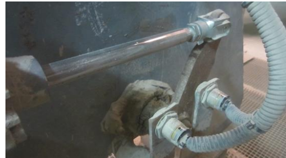
Figura 21. Sensores inductivos utilizados como finales de carrera para la indicación de la posición de una compuerta neumática tipo pantalón.
