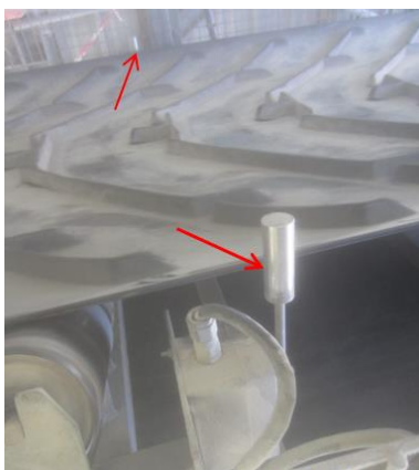
Figura 16. Detalle de un interruptor de desvío.
