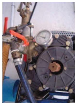
Figura 59. Toma sin protección
