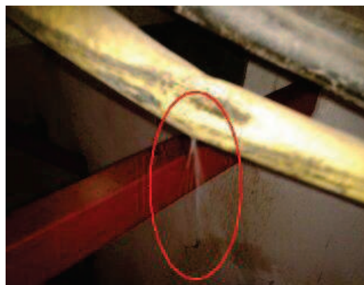
Figura 66. Fuga de producto
