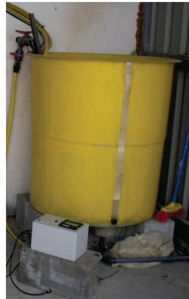
Figura 41. Deposito sin indicador de nivel
