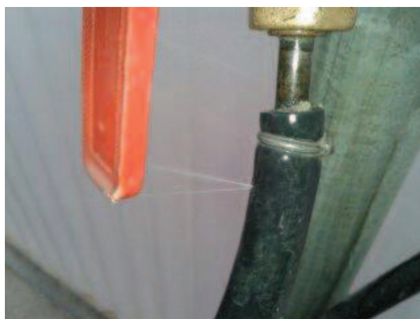
Figura 83. Tubería mal estado
