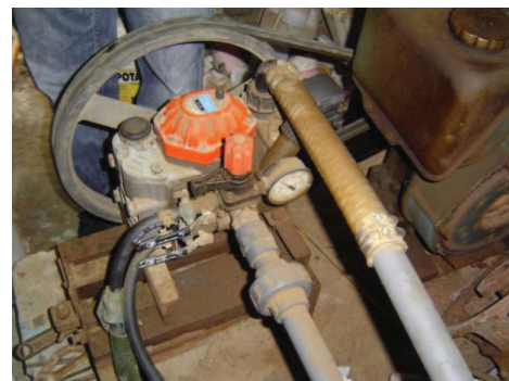
Figura 57. Sin protección en distribución
