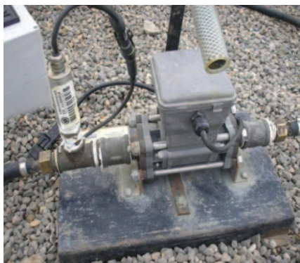
Figura 25. Plataforma de sensores
