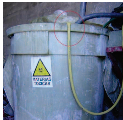
Figura 87. Tuberías mal colocadas
