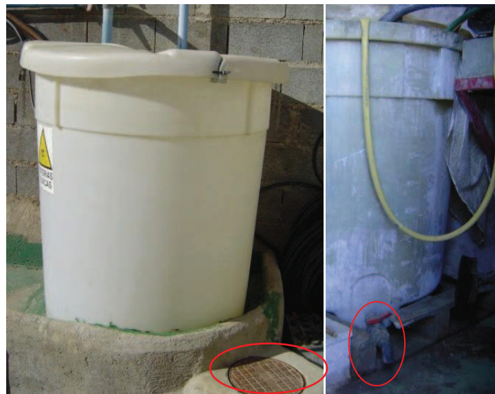
Figura 49. Dispositivo de vaciado
