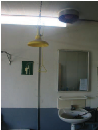
Figura 54. Punto de agua para ducha de emergencia
