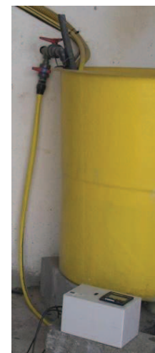
Figura 53. Punto agua limpia
