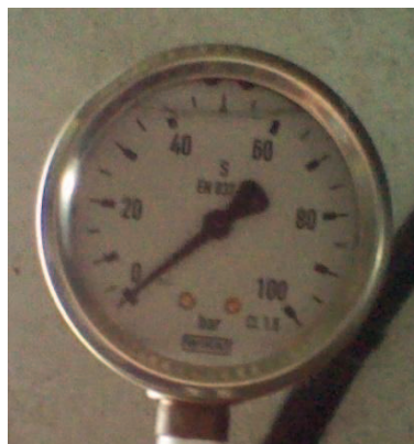
Figura 71. Manómetro inadecuado por escala y rango
