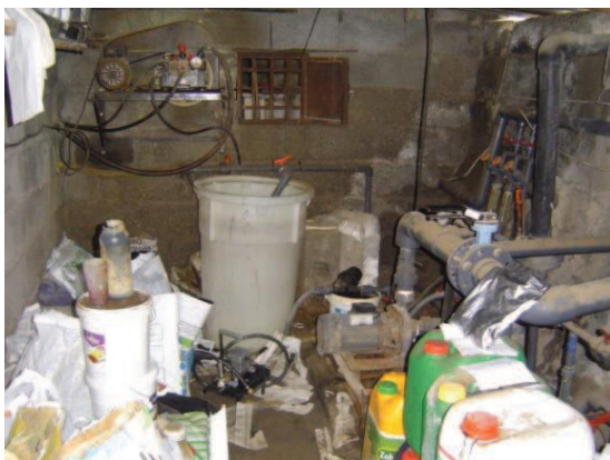
Figura 106. Equipo fijo en mal estado
