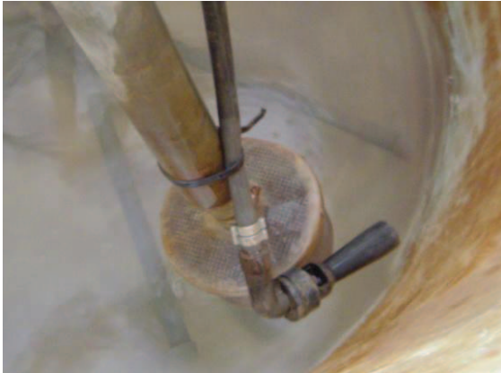
Figura 97. Filtro en buen estado
