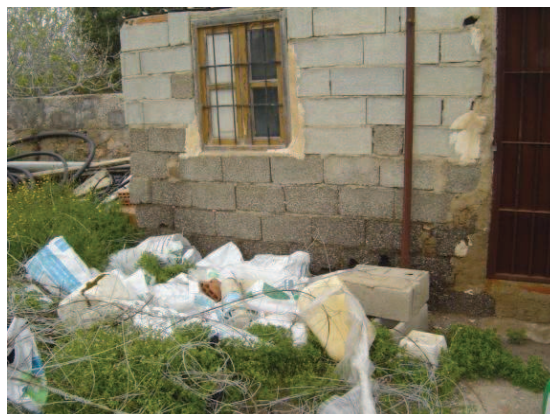
Figura 107. Exterior caseta del equipo
