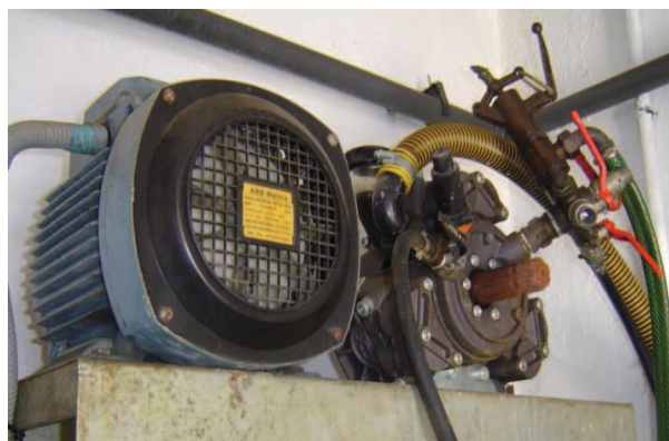
Figura 73. Ausencia de manómetro
