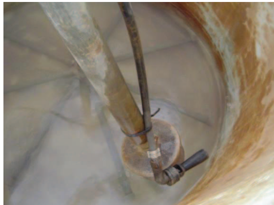
Figura 102. Filtro en aspiración
