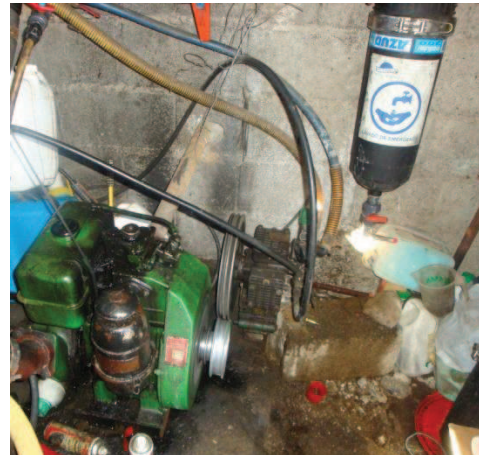
Figura 55. Mal estado del punto de agua
