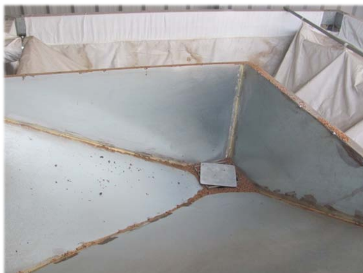
Figura 35. Detalle de la tolva de la caldera.
