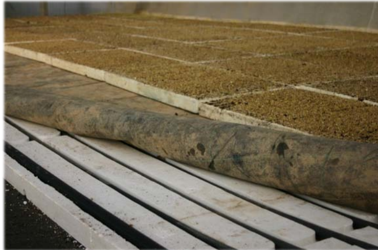
Figura 6. Tuberías de calefacción de suelo.
