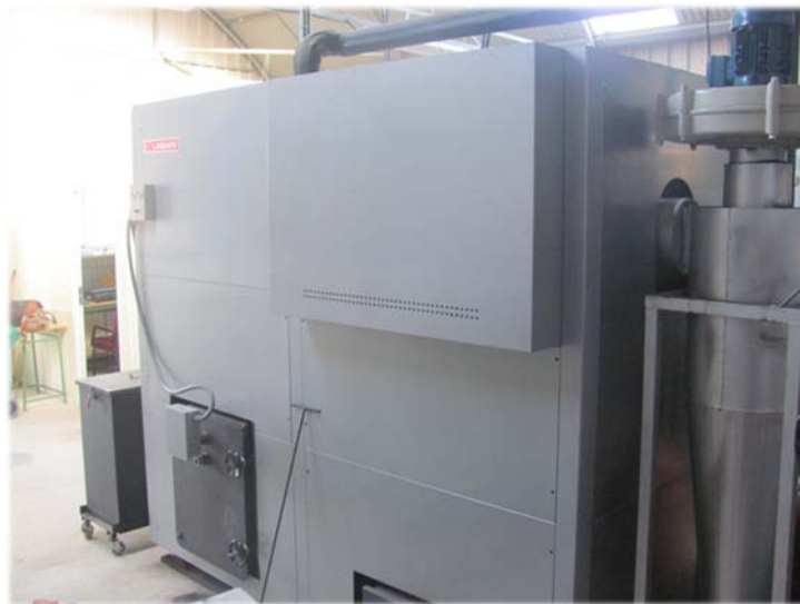
Figura 34. Detalle de la caldera.
