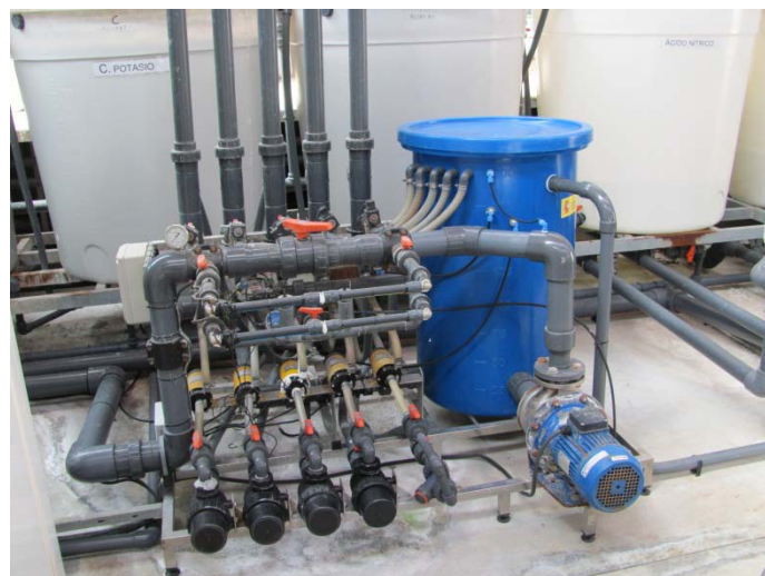
Figura 28. Detalle de cabezal de riego.
