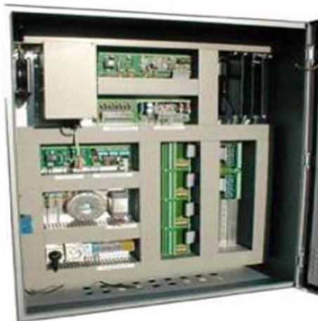
Figura 23. Controlador MultiMa de Hortimax.
