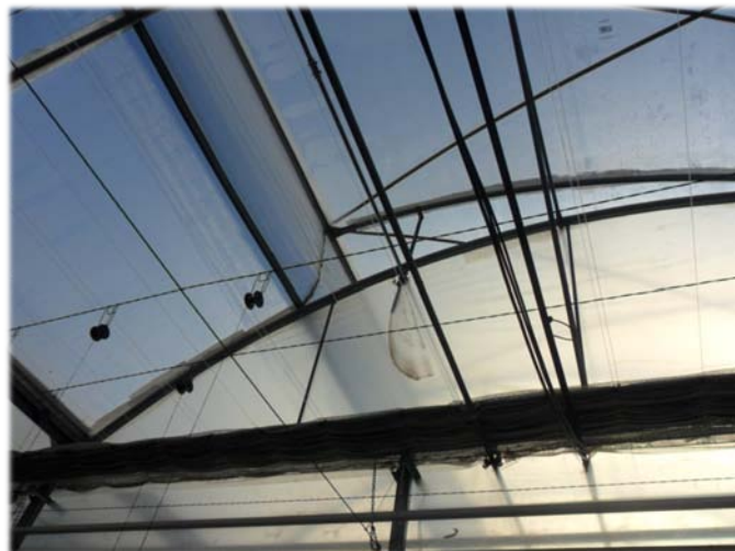
Figura 19. Ventilación cenital en invernadero multitúnel.
