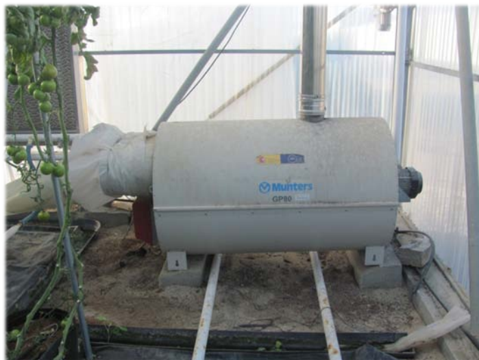
Figura 33. Detalle del calefactor.
