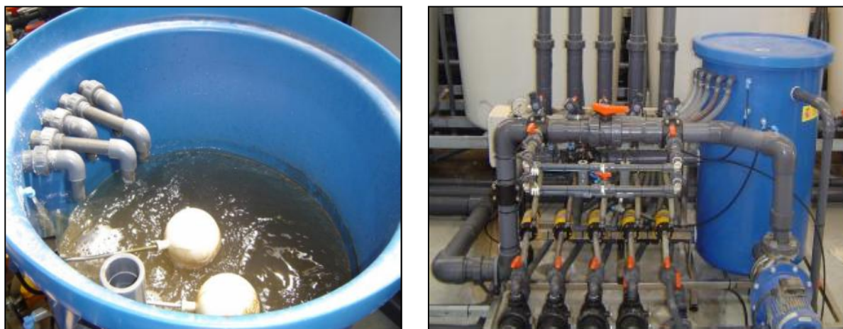
Figura 78. Interior del tanque de mezclas con la solución madre definitiva (izquierda) y cabezal de riego (derecha).
