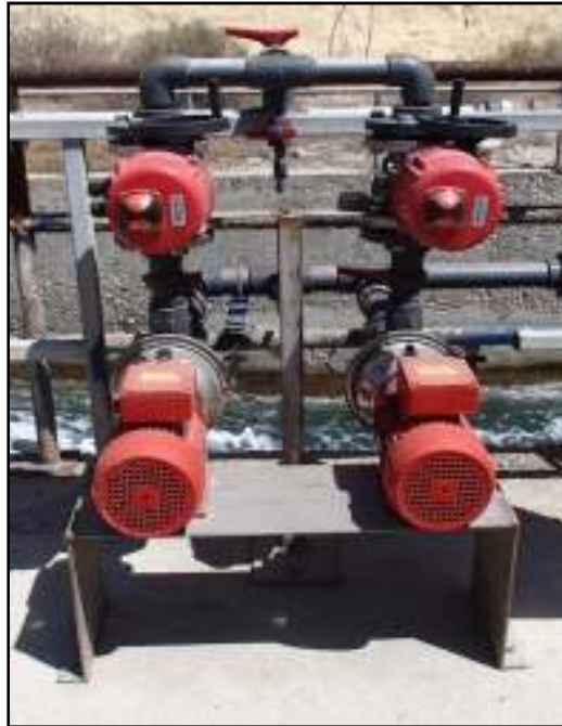
Figura 2.35.- Sistema de bombeo de aguas (Elaboración propia)
