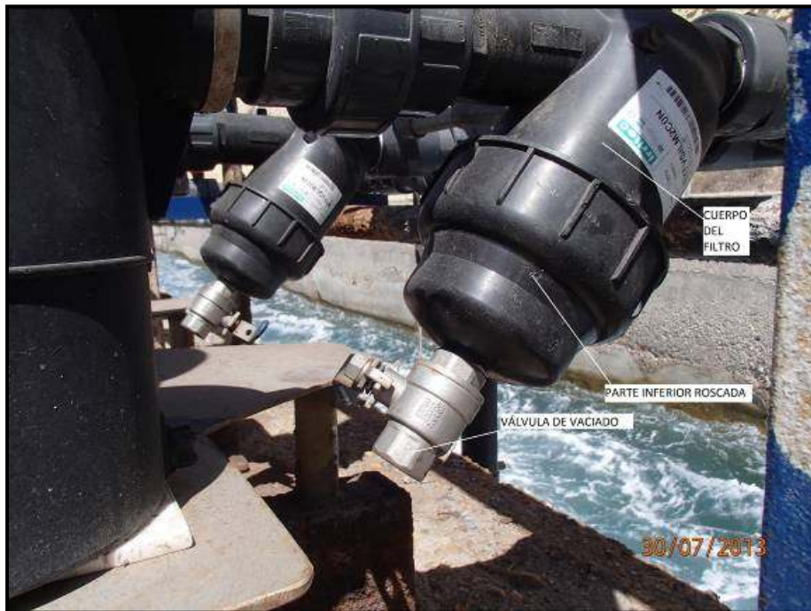
Figura 5.15.- Filtro tipo malla ( Elaboración Propia )
