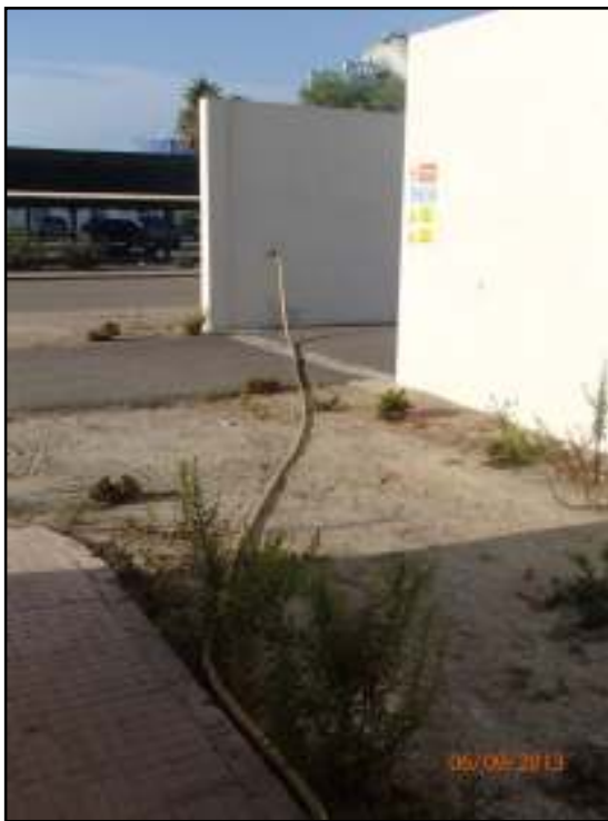
Figura 5.5.- Toma de agua ( Elab. Propia )
