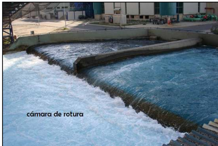
Figura 3.12.- Cámara de rotura de la CTLA (Elaboración propia)
