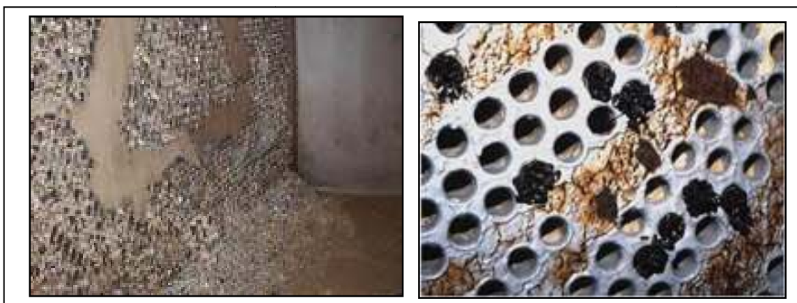
Figura 2.29.- Ejemplos de presencia de vida biológica en los tubos de un condensador (FBS, 2014)
