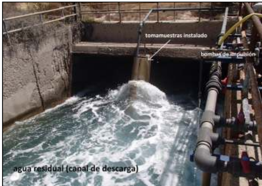
Figura 5.1 – Vista general del tomamuestras instalado y las nuevas bombas de impulsión (Elaboración propia)
