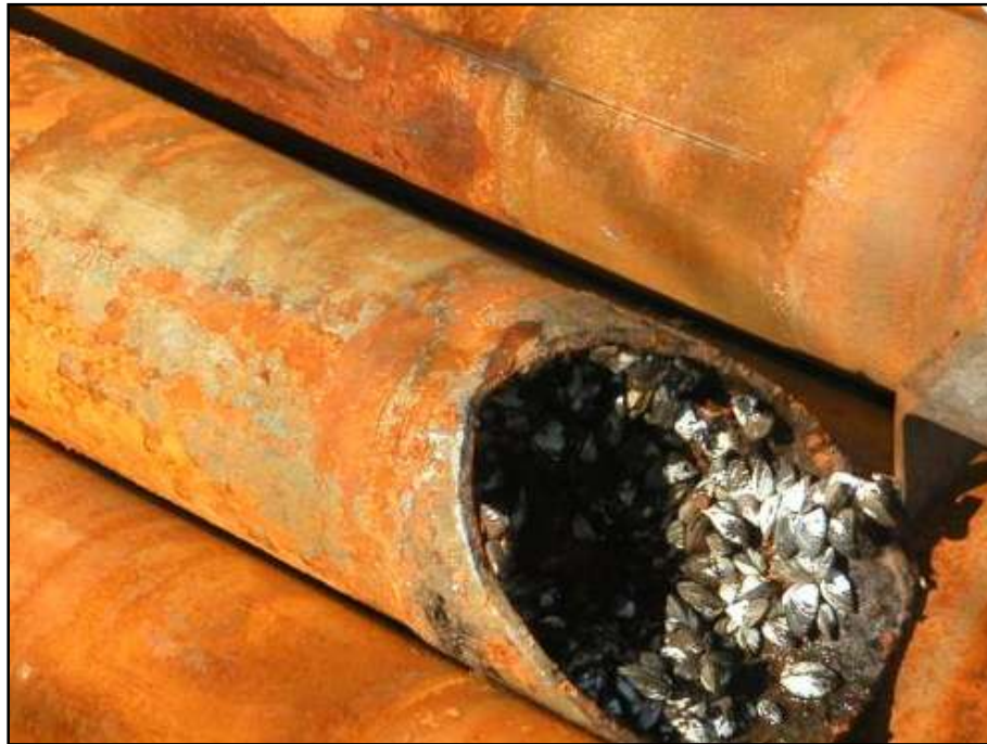
Figura 2.28.- Incrustación de mejillones en los haces tubulares (FBS, 2014)
