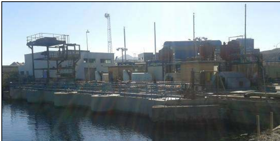
Figura 3.5.- Equipos de aspiración de agua de mar (Elaboración Propia)
