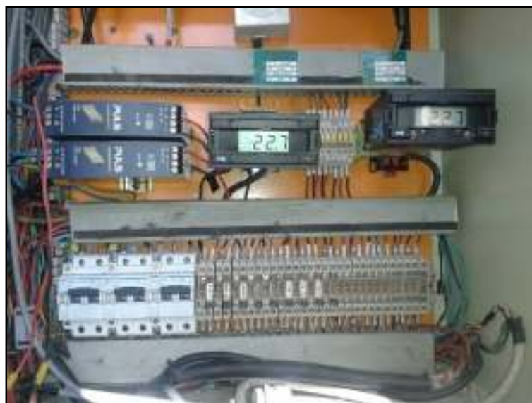
Figura 5.19.- Medidor de temperatura ( Elaboración propia )
