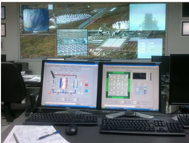
Figura 6.10. SCADA del proyecto TSA-SOLAIR en la sala de control de CESA-1
