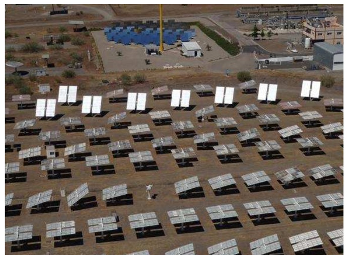
Figura 6.7. Helióstatos con los nuevos controles locales basados en Modbus correspondientes a la línea 8 de comunicaciones del campo CESA-1
