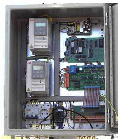
Figura 3.7. Caja de control local
