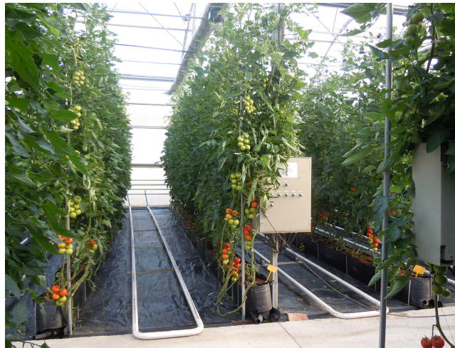
Figura 22. Tuberías sobre el suelo
