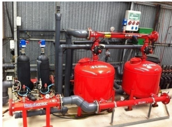
Figura 51. Equipo de filtros de arena.
