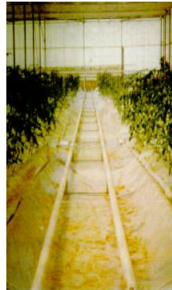
d. Tuberías de calefacción en el interior del invernadero
