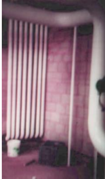
c. Tuberías de salida agua caliente y de retorno
