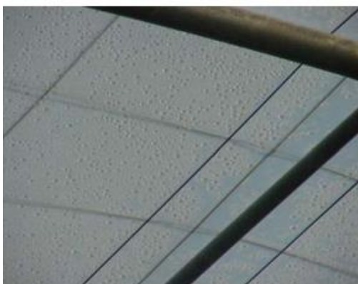
a. Condensación en la cubierta
