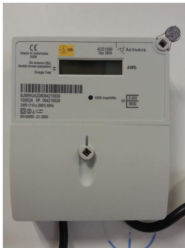
Figura 24: Contador digital utilizado en el proyecto.
