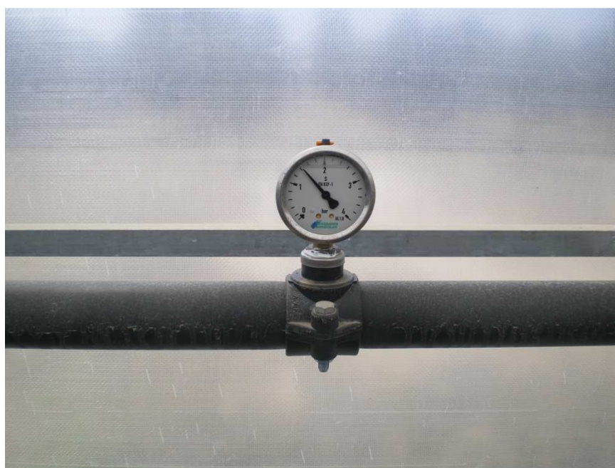
Fotografía 67: Vista general de la colocación de los manómetros a lo largo de la tubería portarramales y detalle de instalación de uno de ellos.
