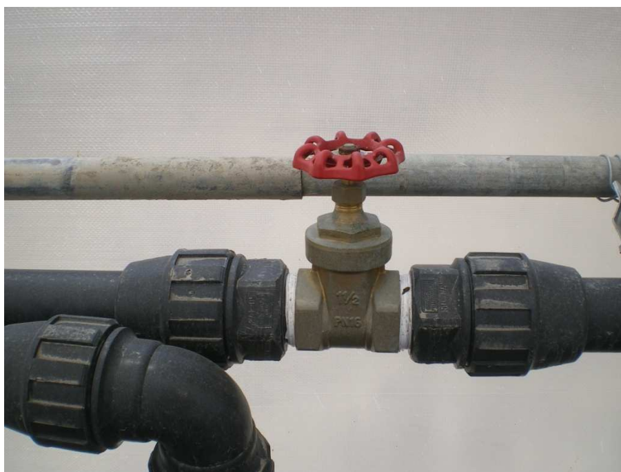
Fotografía 65: Llaves de compuerta elástica de 50 mm, colocadas al comienzo de cada una de las dos tuberías portarramales.
