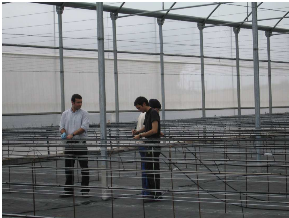
Fotografía 66: Colocación de las bridas como sujeción del ramal portagoteros con el alambre de soporte.
