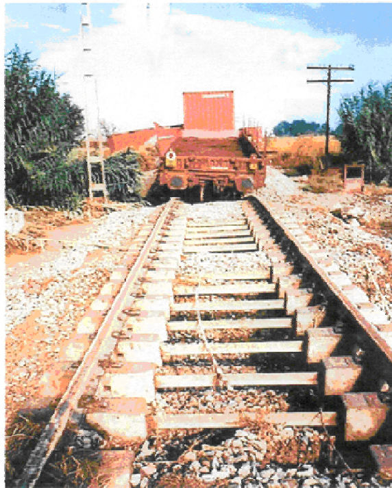
Figura 1.- Deformación en vías a consecuencia de un colapso de suelo. Línea férrea Madrid-Barcelona. (Serrano, 1998)
