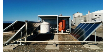
Figura 1: Instalación piloto SMD en la PSA.
