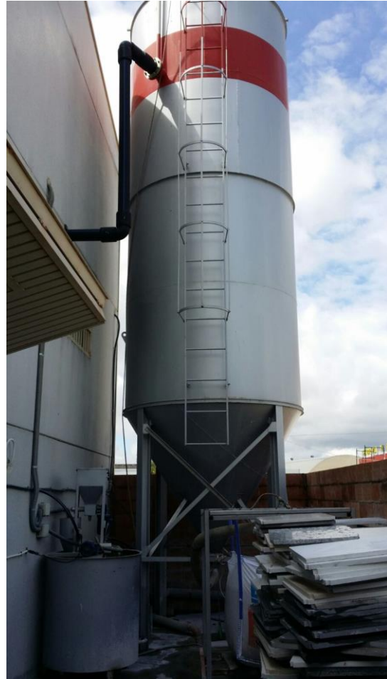
Ilustración 13. Tolva para recogida de polvo.
