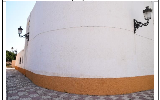
Figura 54: Curvatura en la iglesia de Las Marinas (Fuente: Realización propia)
