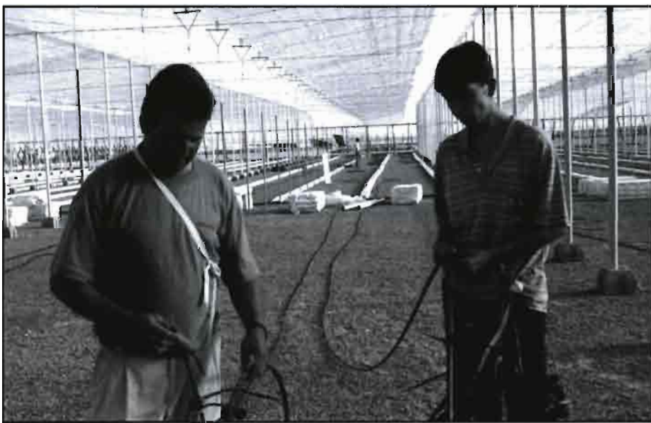
Imagen de la construcción de un invernadero en El Ejido -Almería- y de la instalación de la red de riego por parte de técnicos de la empresa Todagua: el control del consumo de agua de los cultivos es fundamental para la huerta de Almería.
