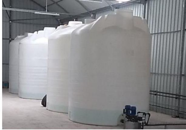
Figura 2.6 Tanques de nutrientes diluidos.
