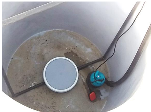
Figura 2.33 Bomba de cosechado en foso.
