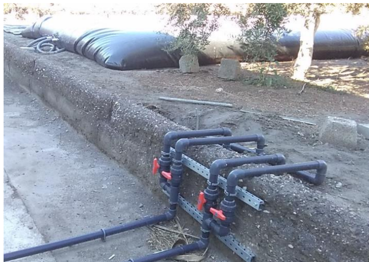
Figura 2.5 Depósitos de acopio y válvulas de selección.
