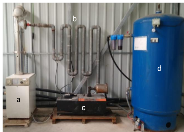
Figura 2.10 Sistema generador de CO 2 a) Quemador; b) Intercambiador; c) Turbosoplante; d) Depósito
