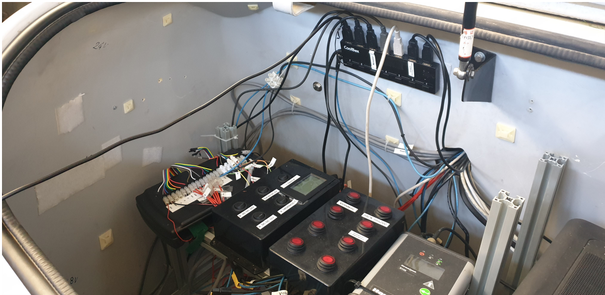
Figura 4.12: Pared del maletero del vehículo donde se ha instalado el regulador de carga del sistema fotovoltaico
