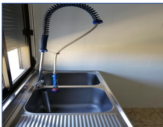
Imagen 2.4. Zona de lavado con fregadero industrial.
