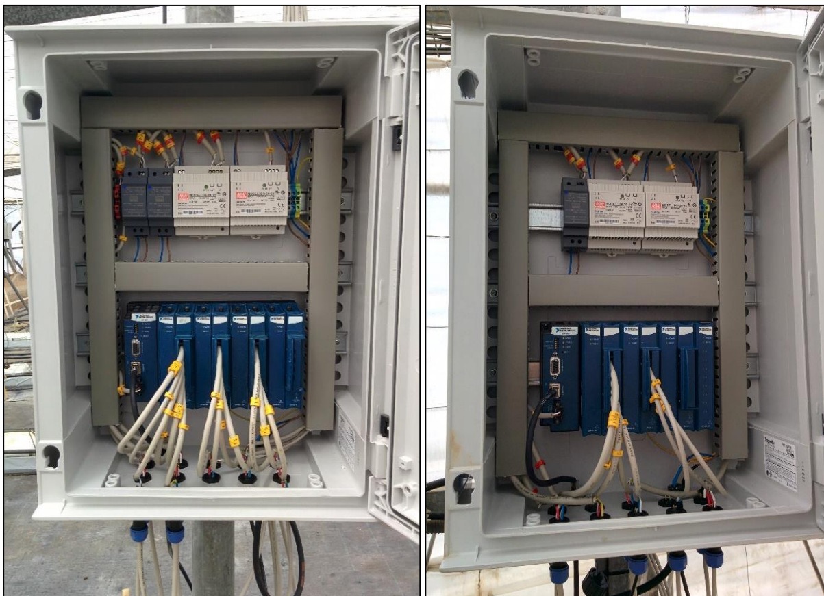
Figura 2.38 Compact Fieldpoints 1 y 2 instalados en el invernadero
